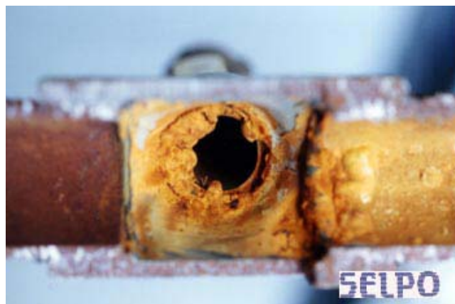
バルブとライニング管の腐食(異種金属接合)
