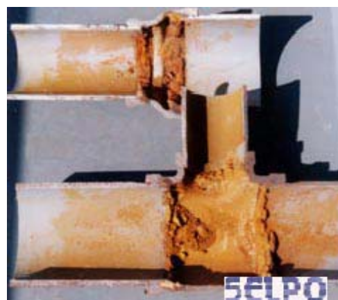
20年経過した給水用ライニング管
