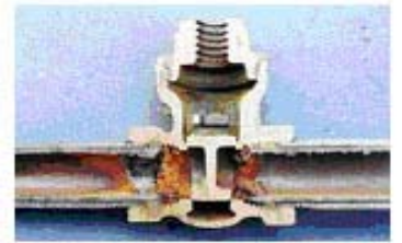
築後20年の塩ビライニング配管内部
