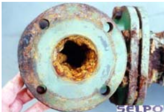
都内高層団地飲料水用フランジ内(築後20年)
