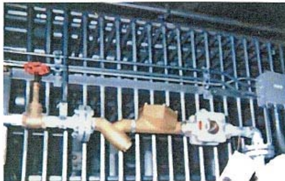
ポローラー型式PI-32CFを冷凍機70RT用として設置
