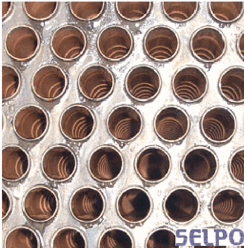
冷温水発生機 熱交換部(上部)
