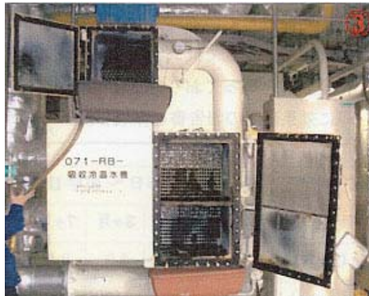
ポーラー利用側S社製 400USRT 吸収式冷温水発生機の開放点検中の状況。 扉の鏡板には白色の薄いミネラルの防食被膜の形成により腐食が無い。
