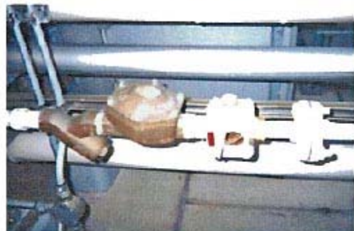
ポローラー型式PI-25CFを冷凍機35RT用として設置
