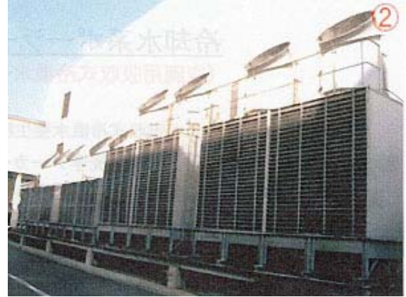
工場内にはこの様な多くの冷却塔があり、年中無休で稼動しています。
