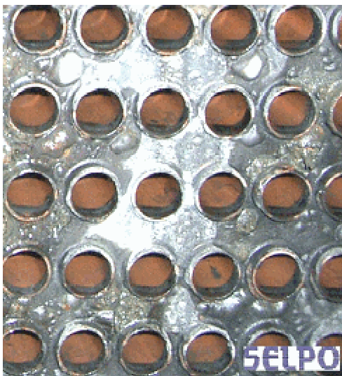
冷温水発生機 熱交換部(下部)
