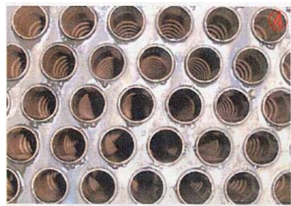
冷温水発生機内部の様子です。 ランゲリア指数 +1.8(スケール発生多し)くらいまで冷却水を濃縮して利用したが、ポーラーの水処理効果によりスケールの付着はない。
