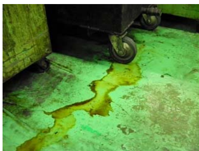
(工場内の油漏れを指摘)
